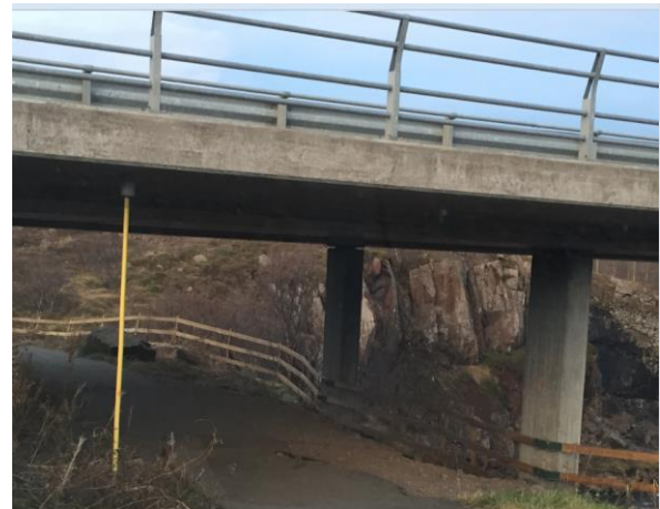
Mynd 3.20 Göngustígur undir Eyvindarbrú er úr sér genginn. Lagt til að endurbæta stíginn og handriðið.
